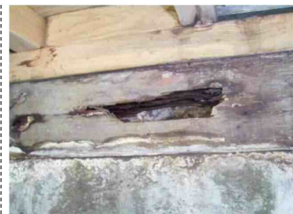
【土台に蟻害が発生している状態】
