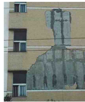
【外壁に脱落が生じている状態】
