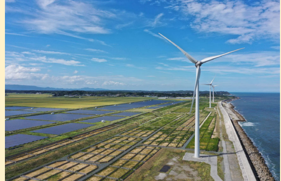
②再生可能エネルギー発電設備（太陽光・風力） (鹿島区)
