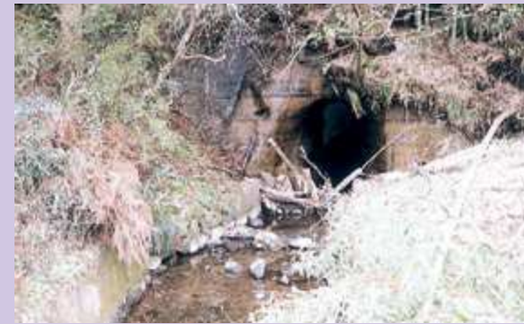
③青根場用水路（平成9年撮影） 高瀬川の水を引いた浪江町の井手から高瀬の丈六ため池までの用水路です。江戸時代前期につくられた用水路でしたが、天明のききん以降、水路の一部が壊れていたため、北標葉郷代官瀬川常明と吟味役手代和田祥重の二人が願い出て改修工事が開始されました。嘉永2年（1849）着工同6年完成。延長6.6km。改修工事は祥重が調査及び工事を担当しました。その際大高倉山に新たに約480mのトンネルを掘り、水の便を良くしました。
