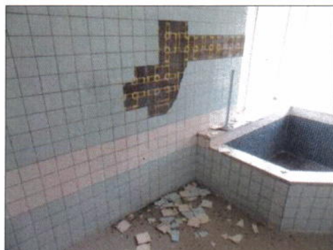
＜農業体験実習館風呂場タイル破損＞
