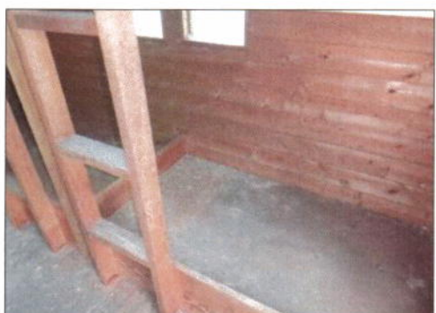
＜バンガロー宿泊室汚損＞
