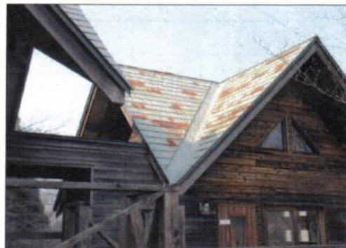
＜バンガロー屋根錆付き＞
