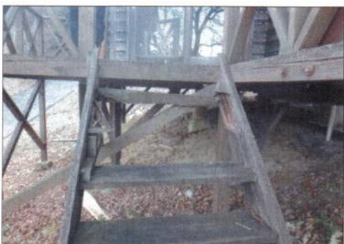
＜バンガロー階段破損＞
