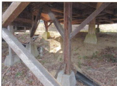
＜バンガロー構造体腐食＞
