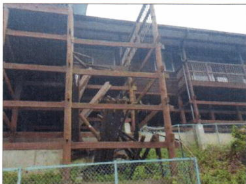
＜農業体験実習館デッキ破損＞
