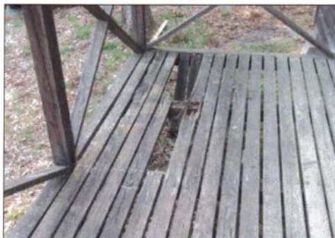
＜バンガローテラス破損＞
