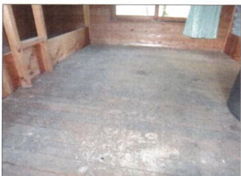
＜バンガロー宿泊室汚損＞
