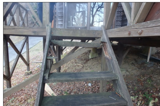
＜バンガロー階段破損箇所＞
