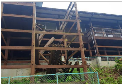
＜農業体験実習館デッキ破損箇所＞
