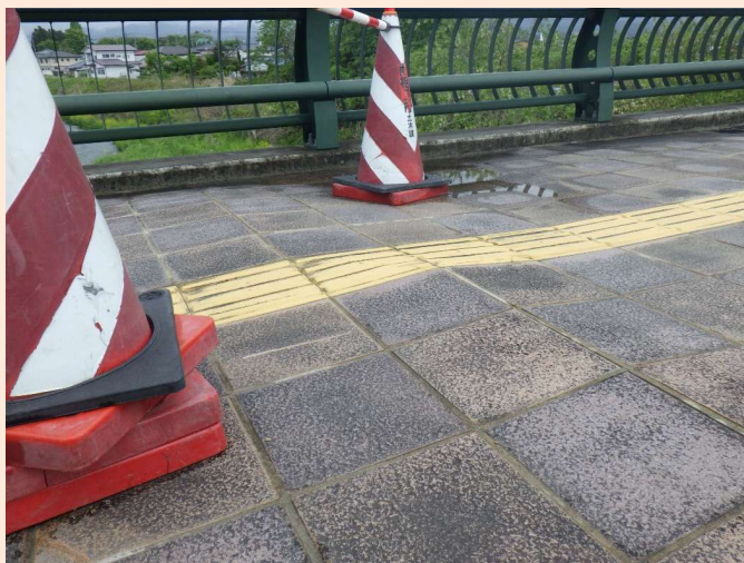
写真 5-1 平成 30 年 5 月 8 日 日常点検による異常確認 新小川橋（原町区小川町地内）
