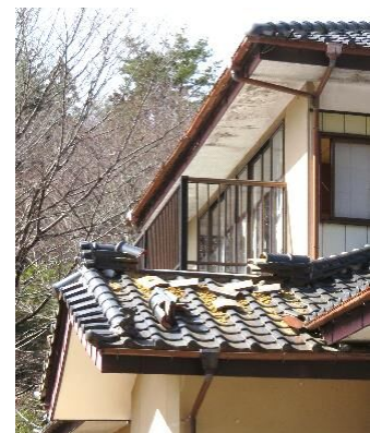
【屋根瓦の被害状況】
