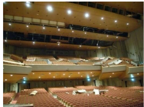
【天井落下被害の状況】
