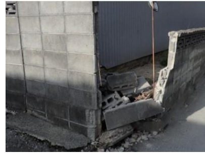
写真4-2 ブロック塀倒壊状況
