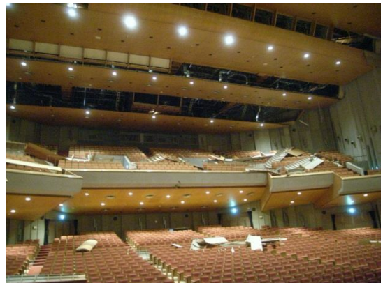
写真2 天井落下被害状況
