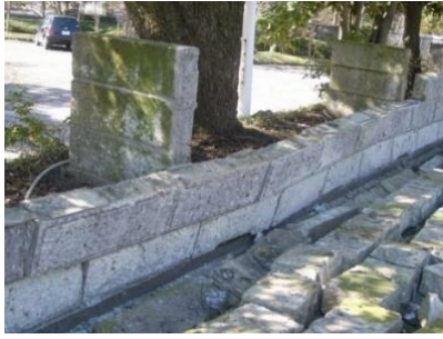
写真4-1 石塀倒壊状況
