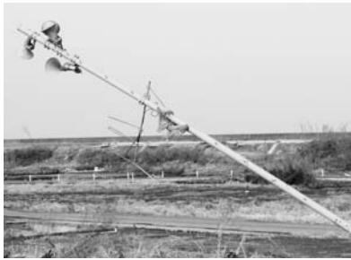
▲倒壊した屋外拡声子局 (小高区角部内)
