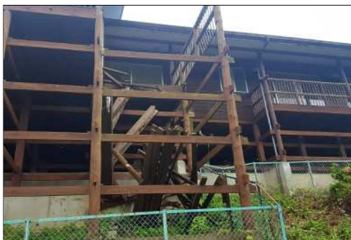
< 農業体験実習館デッキ破損箇所 >
