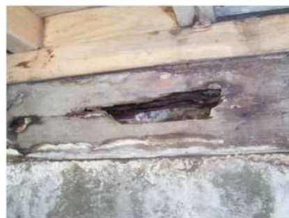
【土台に蟻害が発生している状態】
