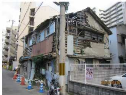
【外壁・屋根ふき材が脱落し、壁体に貫通する穴を生じている状態】
