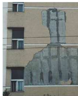
【外壁に脱落が生じている状態】
