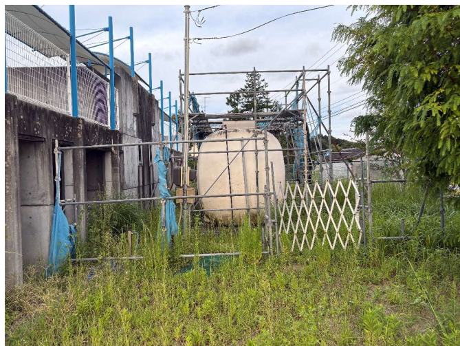
参考写真 地上式浄化槽
