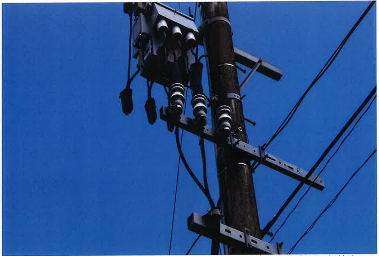
PAS～高圧ケーブル接続 塩害
