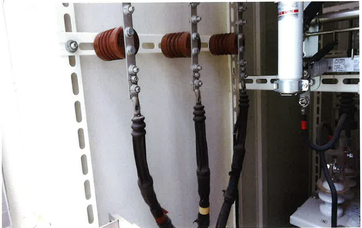
キュービクル内接続
