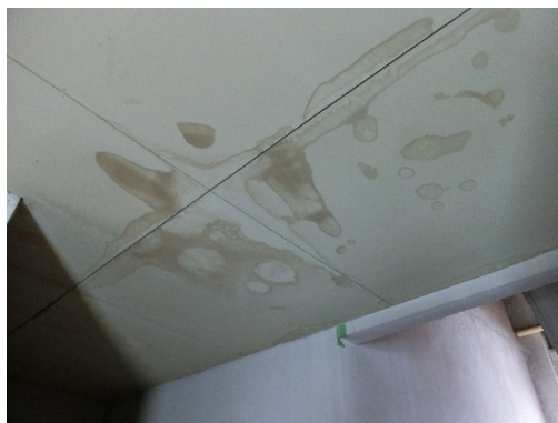
雨漏れ時の天井
