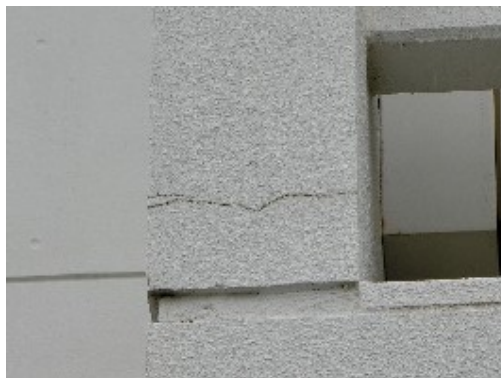
本庁舎のクラックの状況
