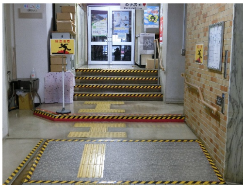
バリアフリー対策が困難な箇所
