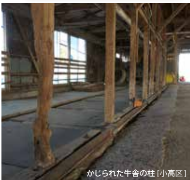
かじられた牛舎の柱【小高区】
