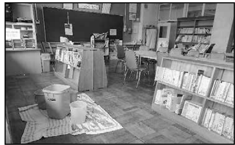
写真11 移動先の図書室で雨漏りを確認した
