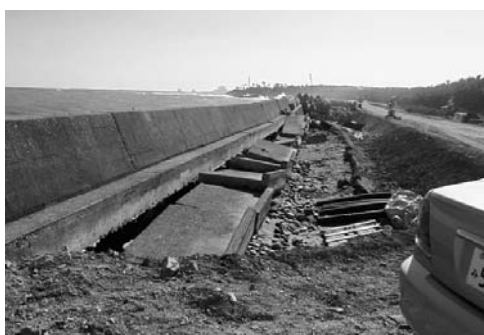
▲ 10月6日 豪雨被害 (鹿島区港地区)
