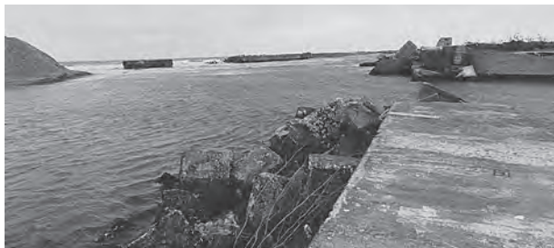
真野川河口の被害状況
