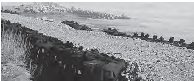
流された防潮堤（原町区栗）
