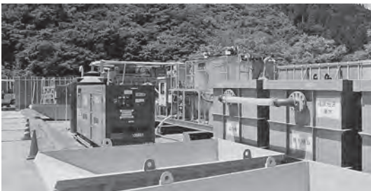
農地除染の濁水処理施設（鹿島区）
