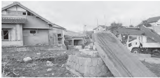
解体が待たれる被災家屋（20km圏内）
