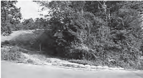
土砂が流出した林地開発現場
