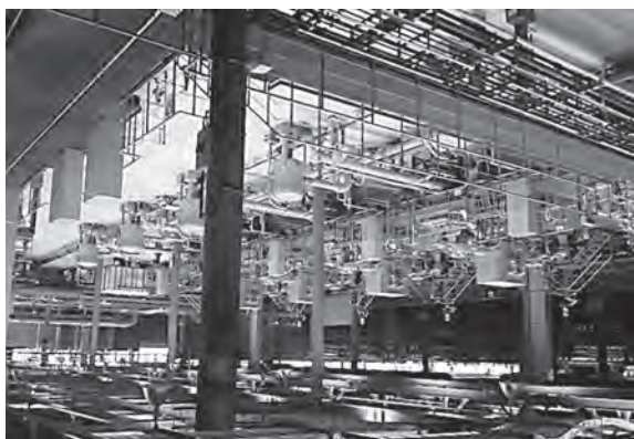
まみずピア濾過装置（福岡県福岡市）
