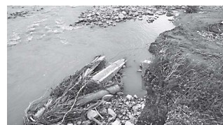
ダム放流により決壊した堤防（高倉地区）
