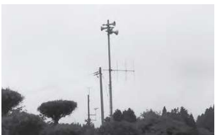
防災行政無線（原町区）
