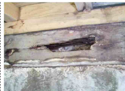
【土台に蟻害が発生している状態】
