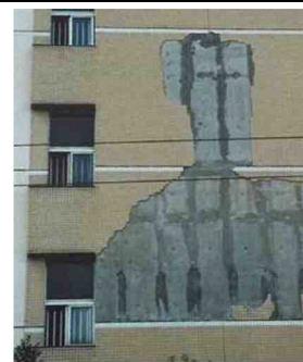
【外壁に脱落が生じている状態】
