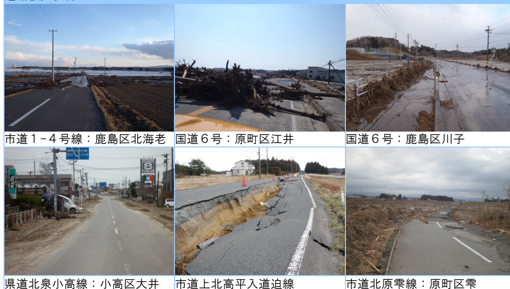
道路被災状況
