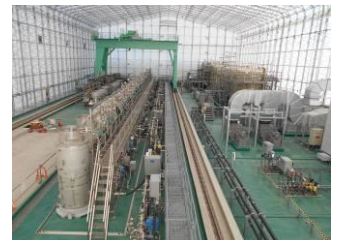
(高性能多核種除去設備)
