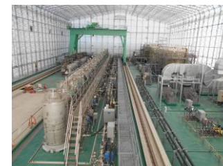
(高性能多核種除去設備)
