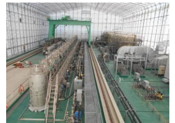
(高性能多核種除去設備)
