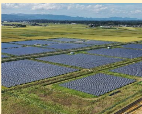
津波浸水域に整備された太陽光発電所
