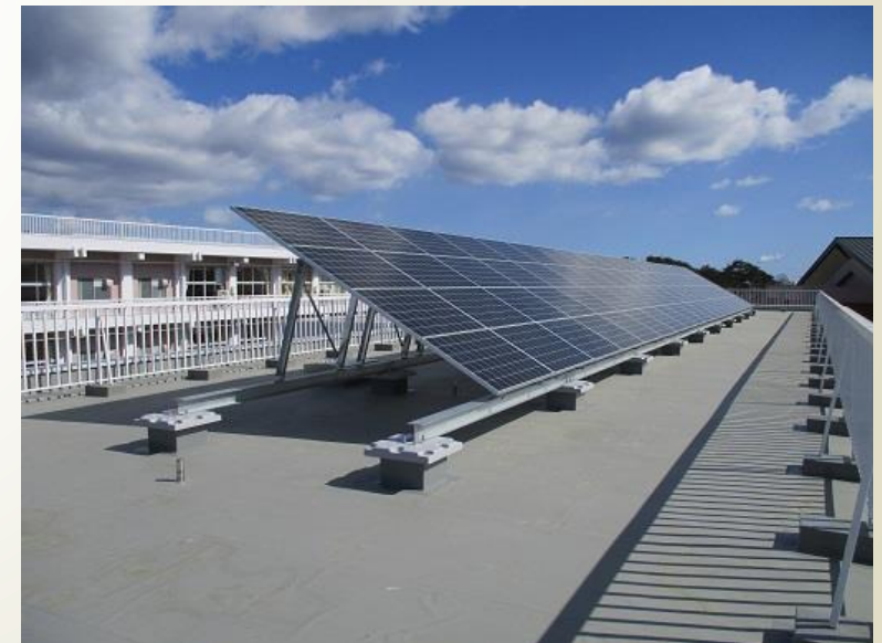
原町第三小学校校舎屋上に設置した太陽光パネル
