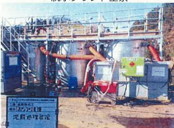
凝集沈殿処理状況
