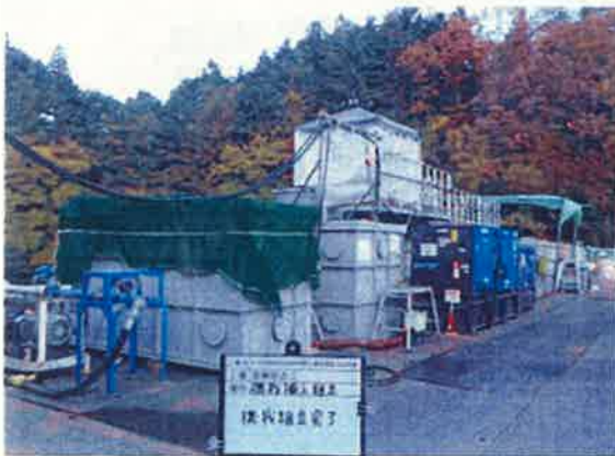
脱水プラント全景
